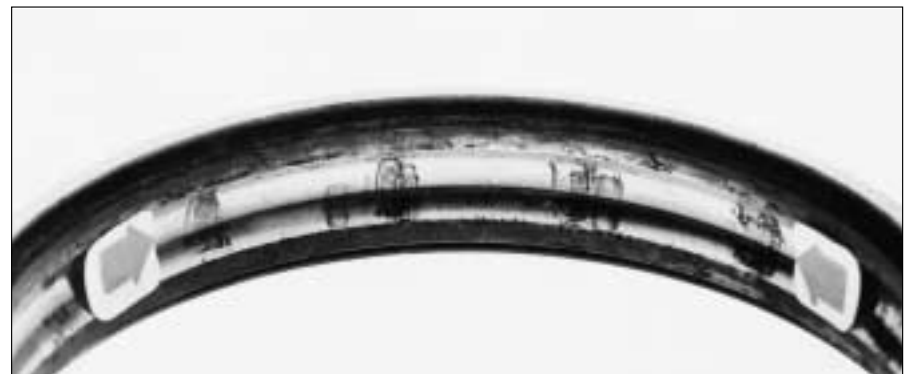
54: Excoriaciones producidas por oxidación en el camino de rodadura a la distancia de los cuerpos rodantes
